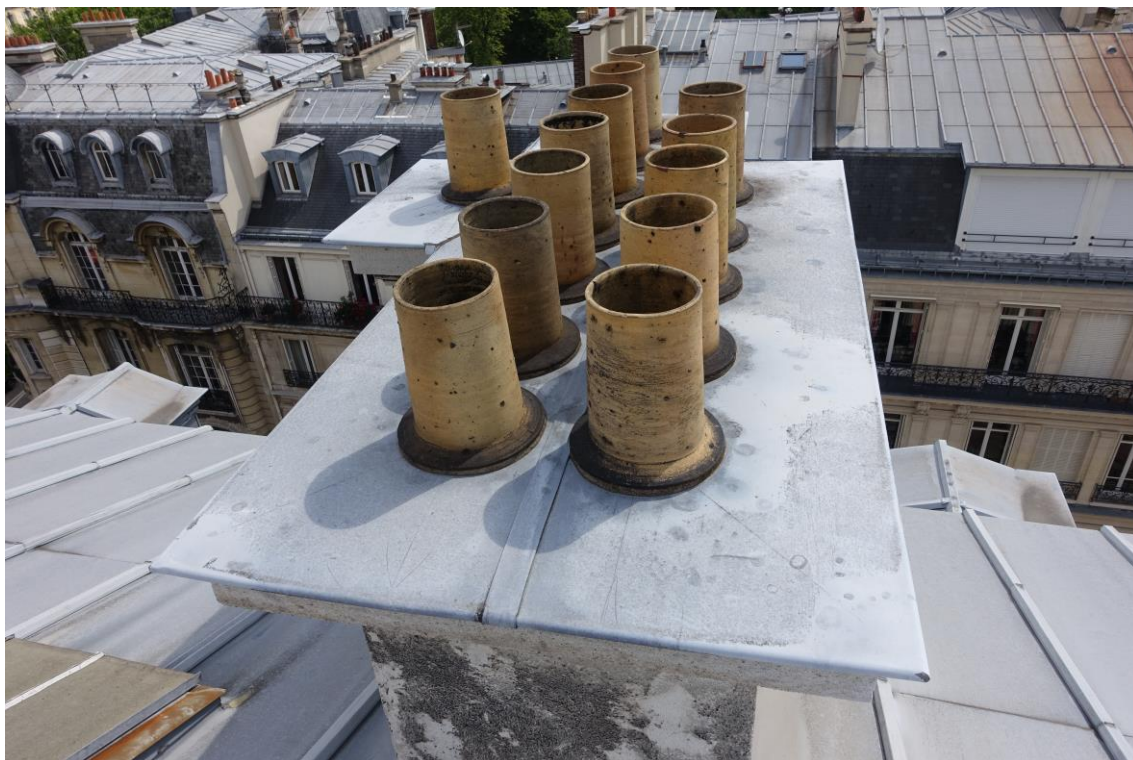
Les scellements des mitrons sont à vérifier.
