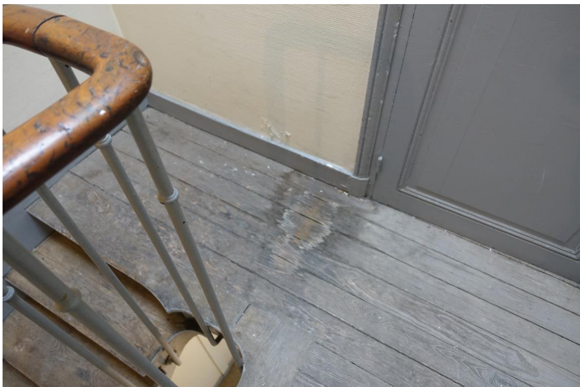
Fuite sous le châssis.
