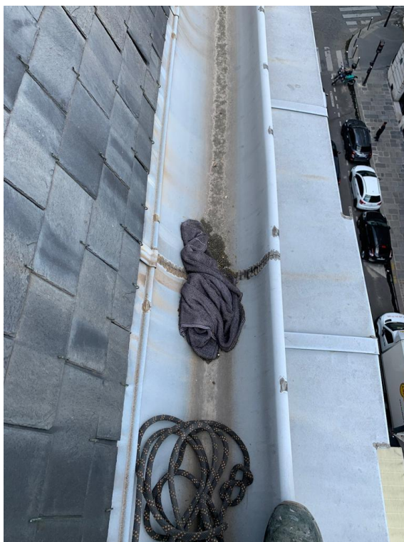
Obstruction des écoulements
