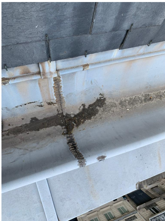
Soudures cassées dans le chéneau.
