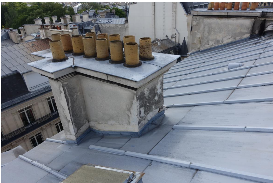
Ici encore quelques solins dégradés.
