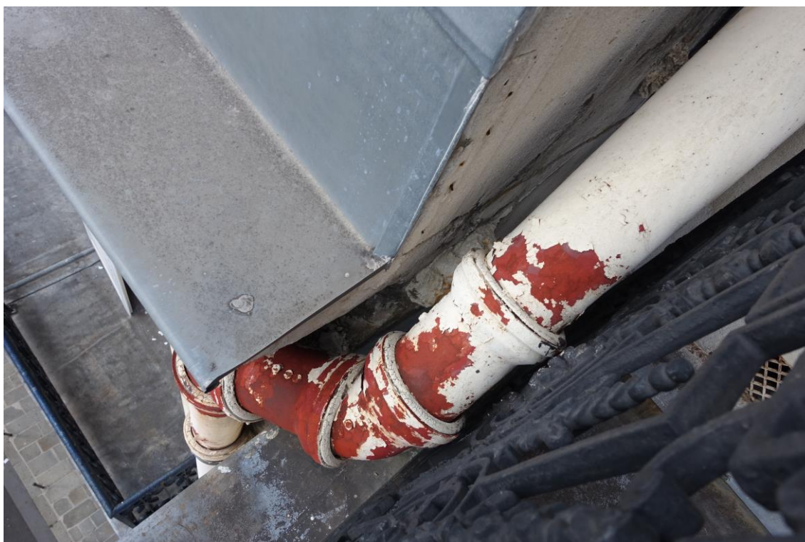
Au niveau du balcon, dégradation des raccords maçonnés derrière la descente en fonte.
