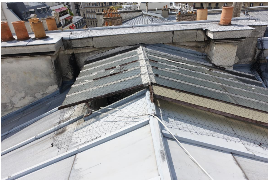
Le filet est HS, les joint de la verrière sont à revoir.
