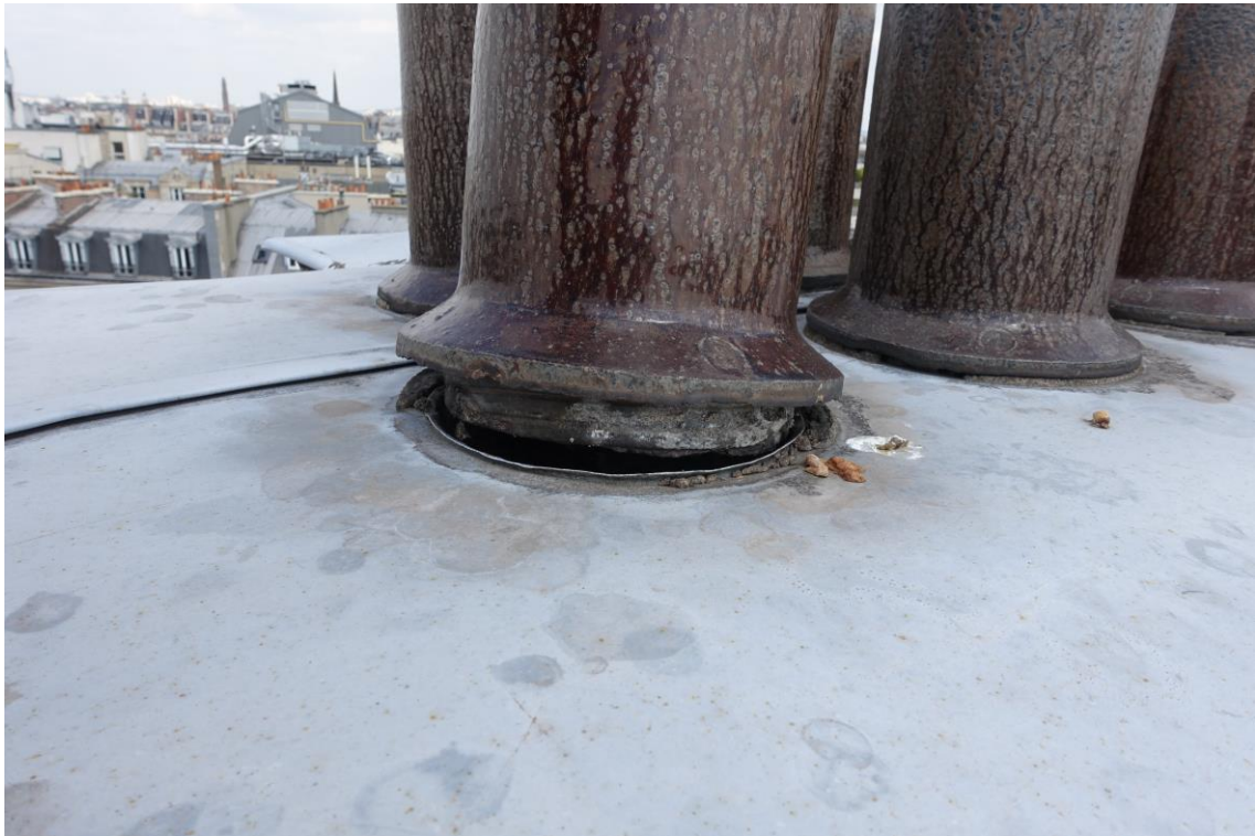
Quelques mitrons sont désolidarisés, risque de chute.
