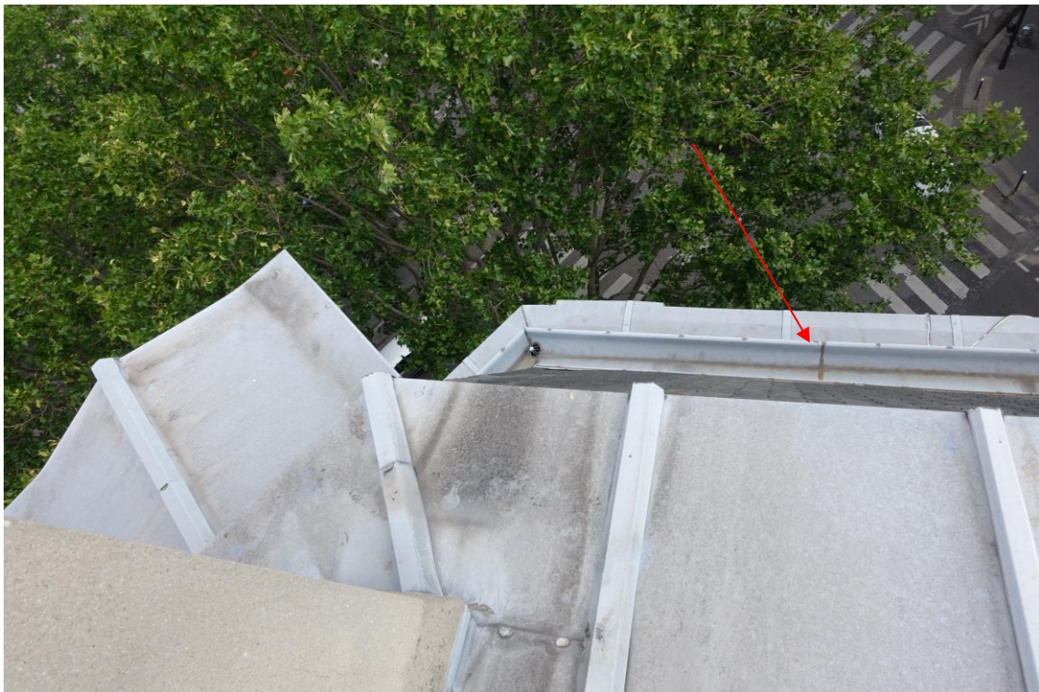
Les soudures du chéneau sont à vérifier dans l'ensemble.
