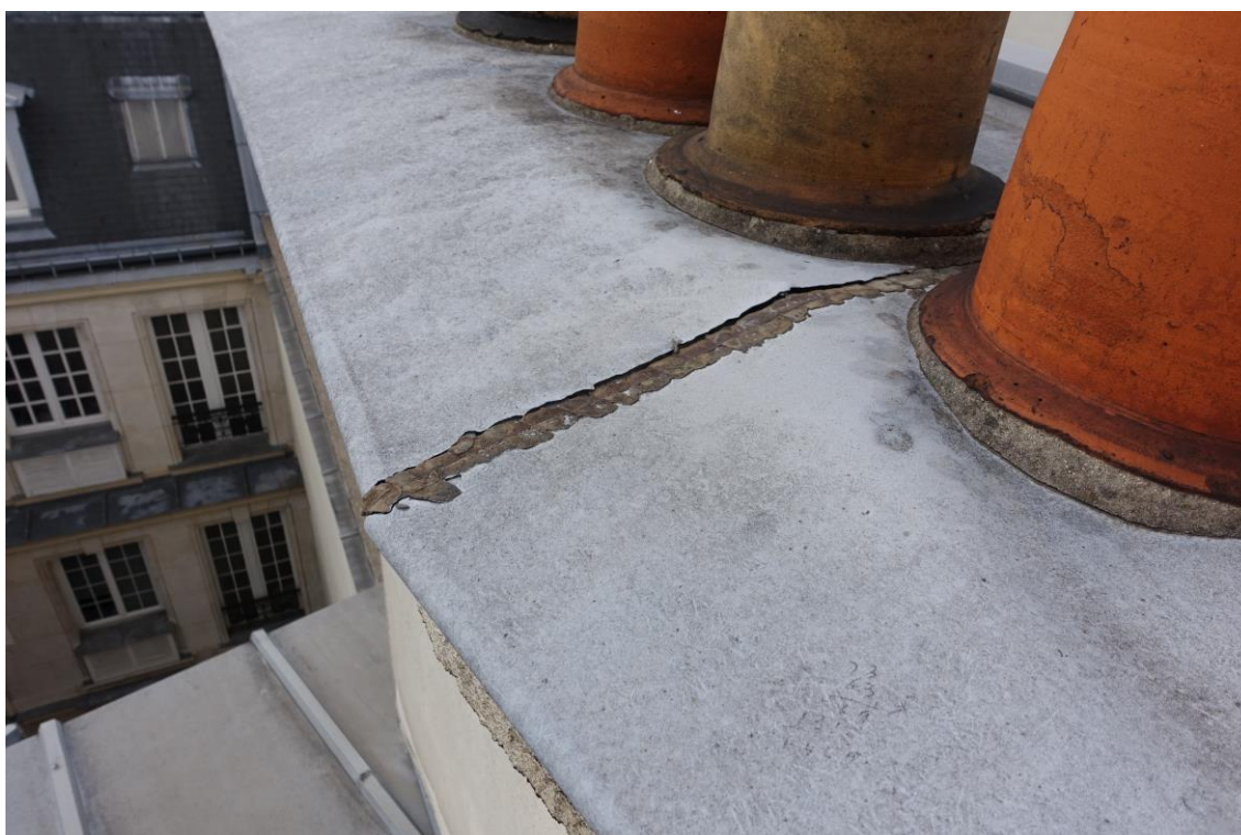
Quelques soudures cassées.
