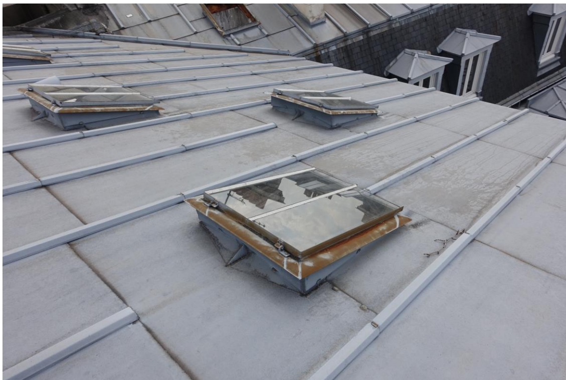
L'ensemble des châssis sont rouillés.
