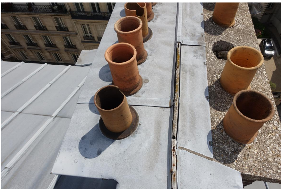
Absence de couvre joint en zinc.
