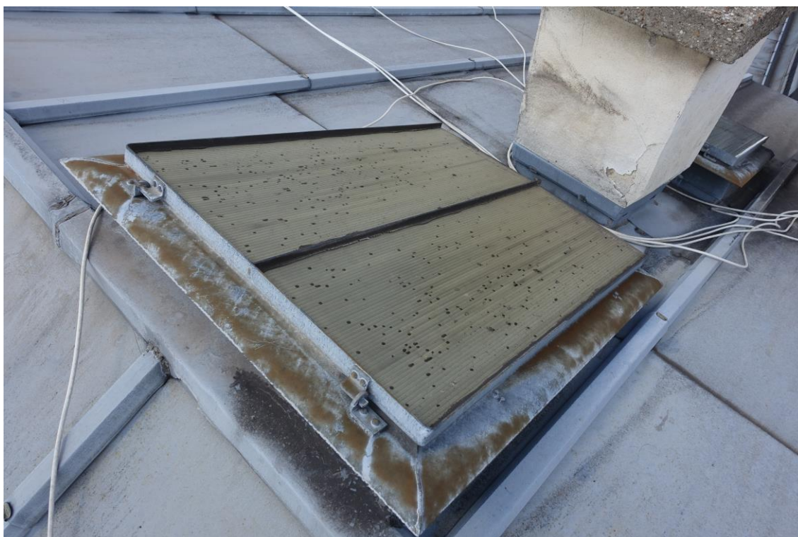
Les remplissages (polycarbonate) des châssis sont percés.
