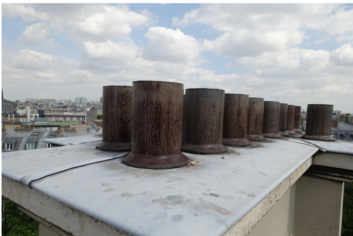
Le scellement des mitrons est à revoir dans l'ensemble.
